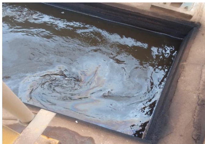
Figure3. 3 : Bassin de Coagulation et Floculation
