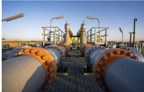
Figure2. 4: Supervision technique du réseau de transport par canalisations
