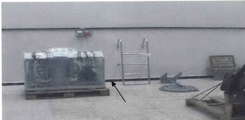
Photo N° (19) : Compresseur HP
