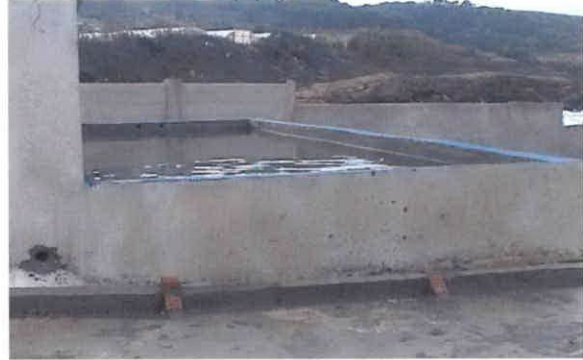
Photo N° (13) : Bassin réservoir
