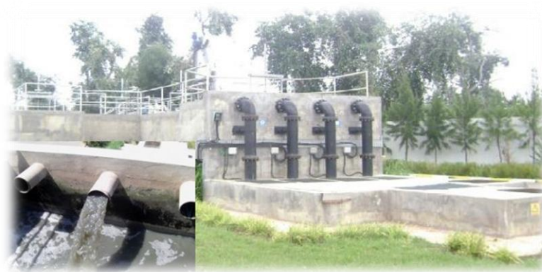
Figure III.3 : Poste de relevage.
