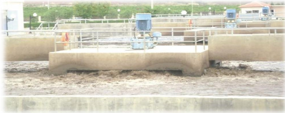
Figure III.9: le bassin biologique.
