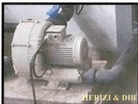
Figure 34 : Une pompe de recirculation (AQUA TAFNA, 2007)
