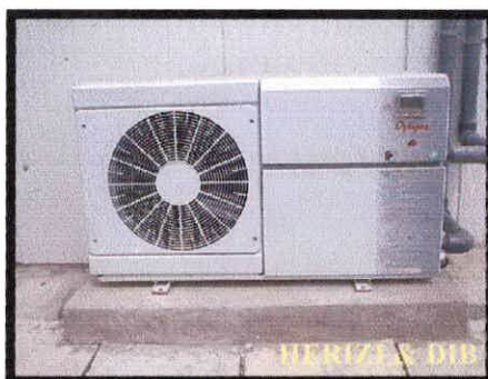
Figure 38: Groupe de chauffage et de refroidissement (AQUA TAFNA, 2007)
