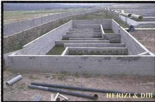
Figure 29: Bassin de décantation de l'eau
