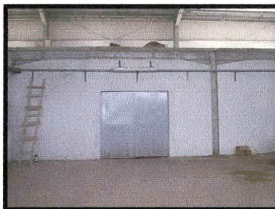
Figure 55 : Entrée du groupe électrogène
