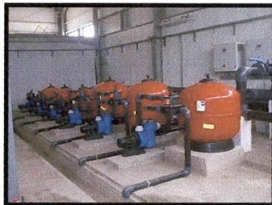
Figure 53 : Les filtres de la station de pompage
