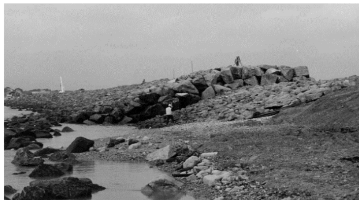
Figure 4: Revêtement en enrochement, Hurst Spit, Royaume-Uni.
