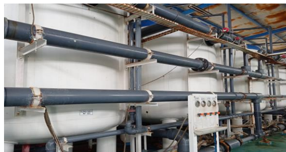
Figure 44: Photographie des filtres à sable.
