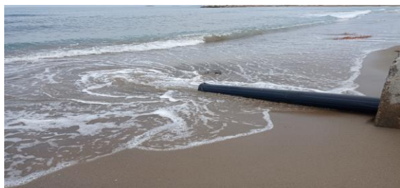
Figure 42: Tuyau de captage de l'eau de mer.
