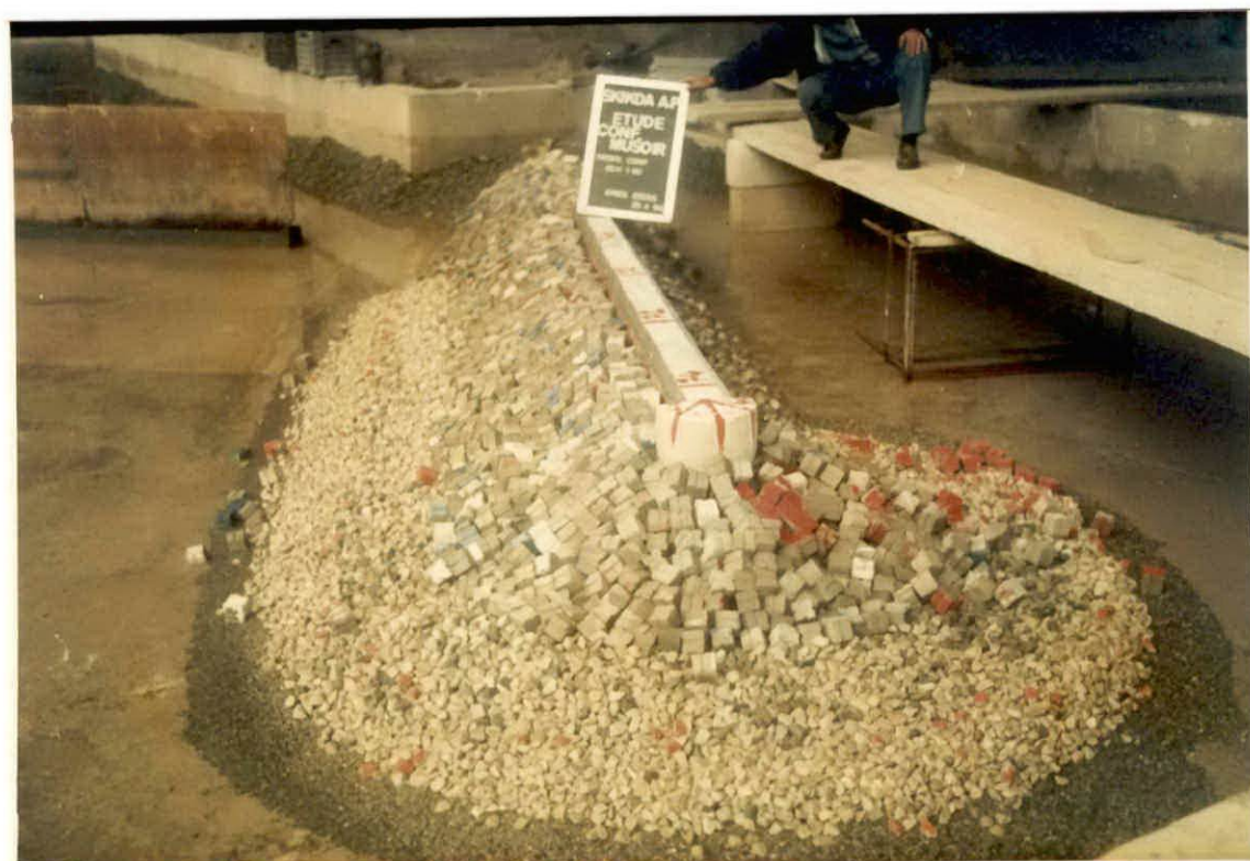
PHOTO 18 : Vue générale, variante 1 direction N 26° après essais (Hs=9,97m, Tp=15s). Dégats localisés côté intérieur du Musoir.
