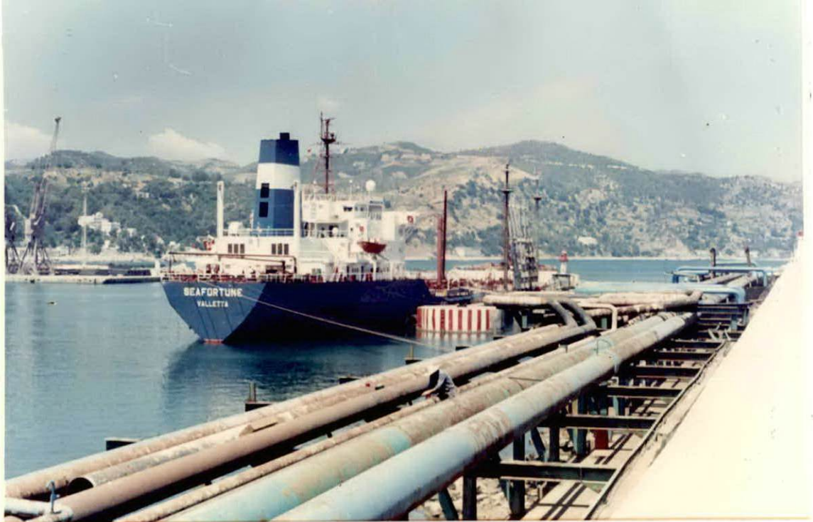
PHOTO 5 : Corrosion des reseaux de pipes de SONATRACH qui alimentent le poste pétrolier.P2.
