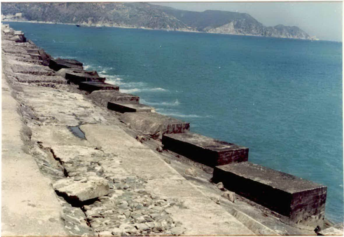
PHOTO 4 : Erosion des blocs de maçonnerie du couronnement par la houle franchissante. (Absence de carapace).
