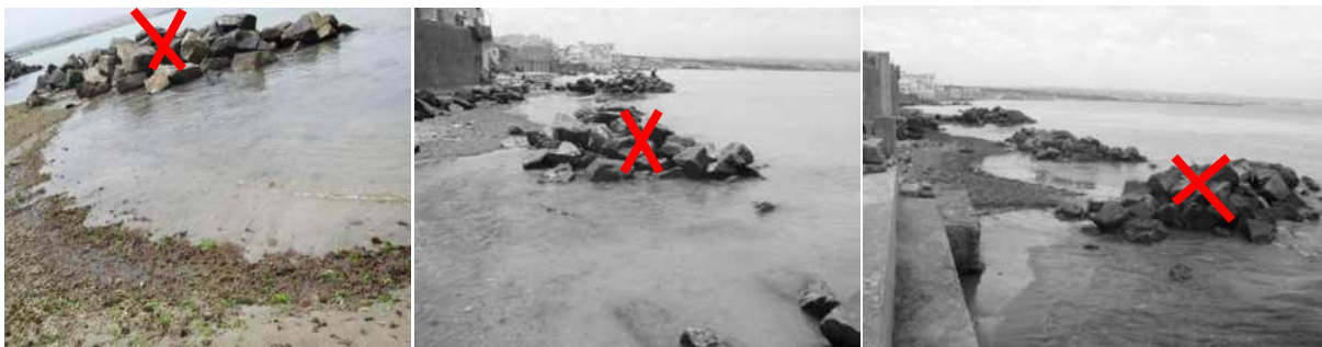
Photo VI.7. Les digues d'enrochement anarchiques dans la plage Ouest (07/03/2011).
