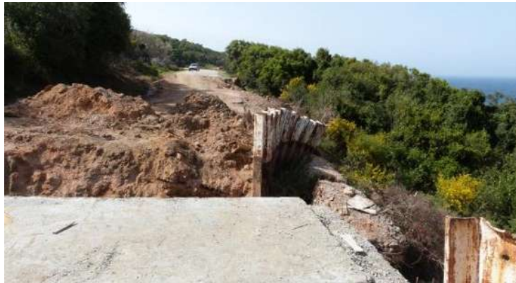
Figure V. 4 : Glissement de terrain sur le chemin de wilaya n° 166
