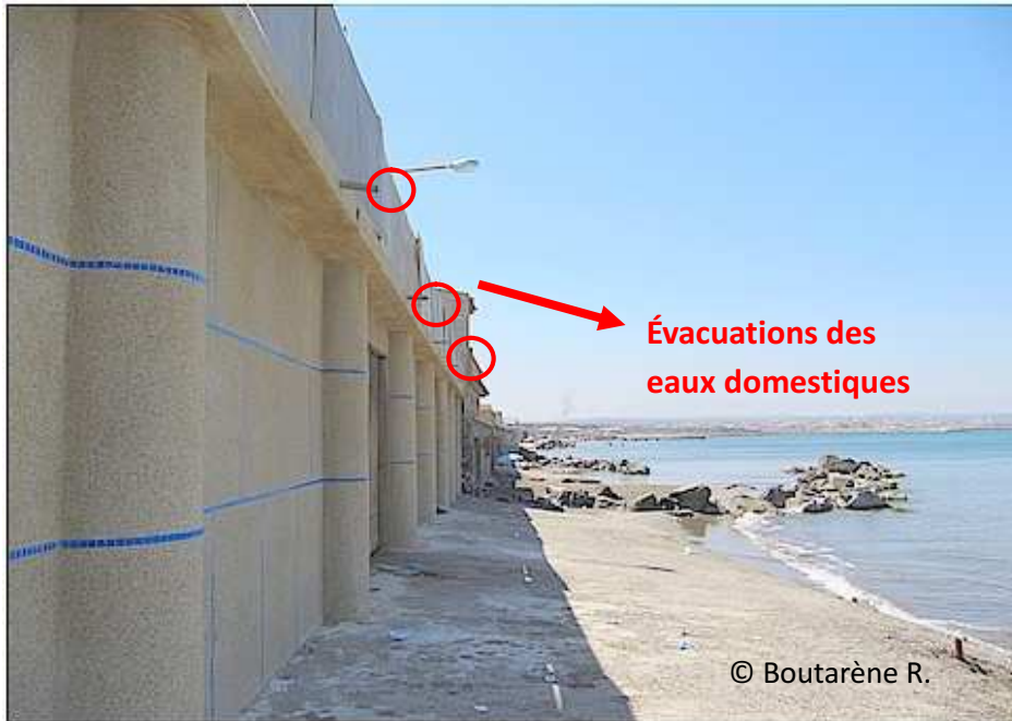
Fig. 36 a. : Evacuation des eaux domestiques des habitations le long de la côte ( plage ouest de Sidi Fredj).
