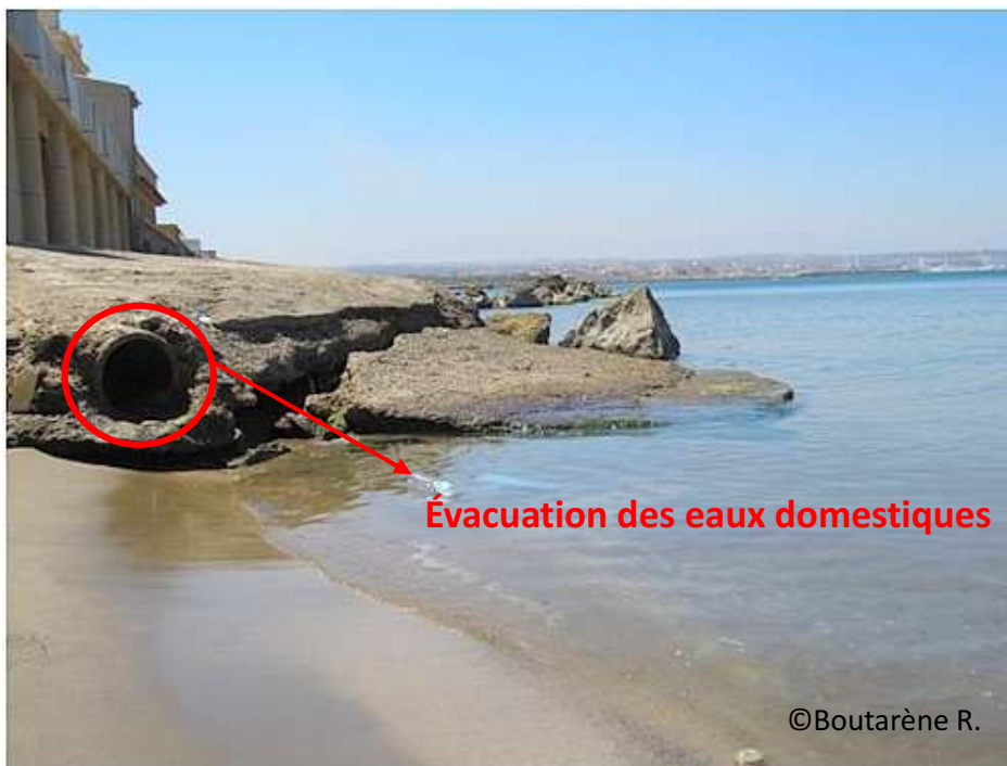
Fig. 36 b. : Evacuation des eaux domestiques des habitations le long de la côte (plage ouest de Sidi Fredj).
