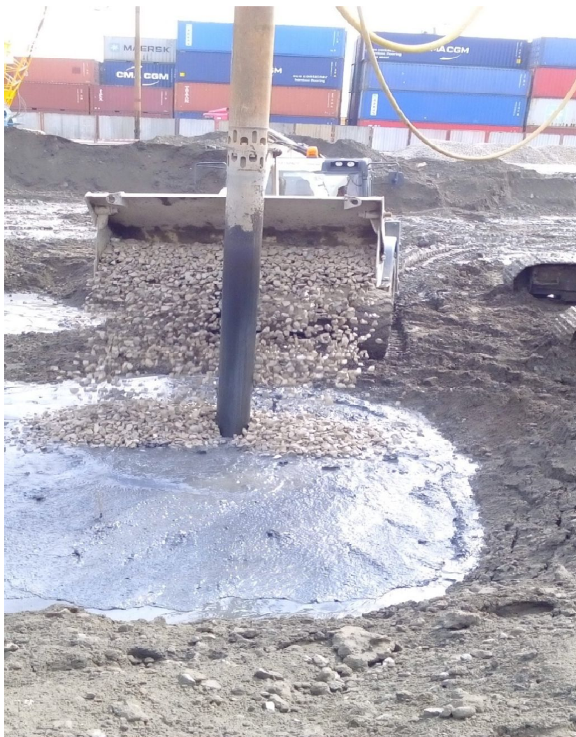
Figure III. 1. Réalisation d'une colonne ballastée par voie humide au niveau du TAC du port d'Alger
