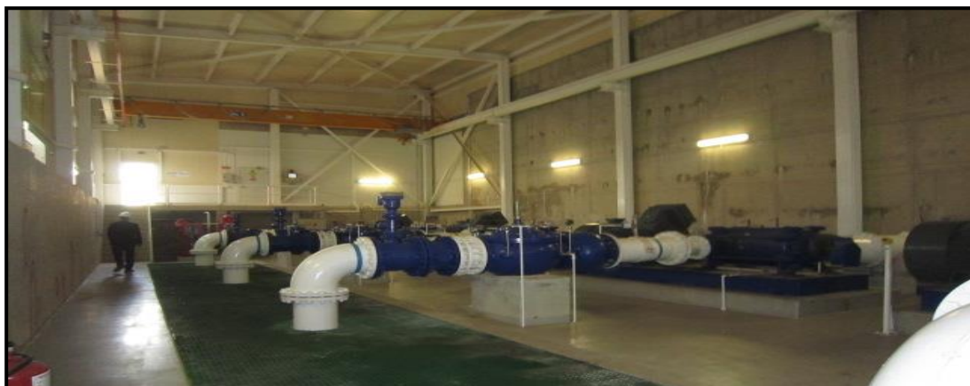
Figure V.15 : Station de pompage d'eau traitée
