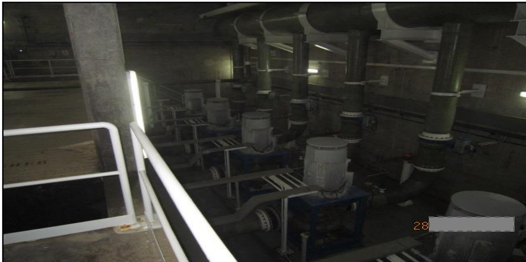
Figure V.08 : Station de pompage d'eau brute
