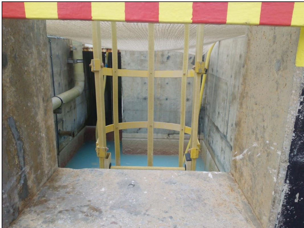
Figure II.04: réservoir des effluents
