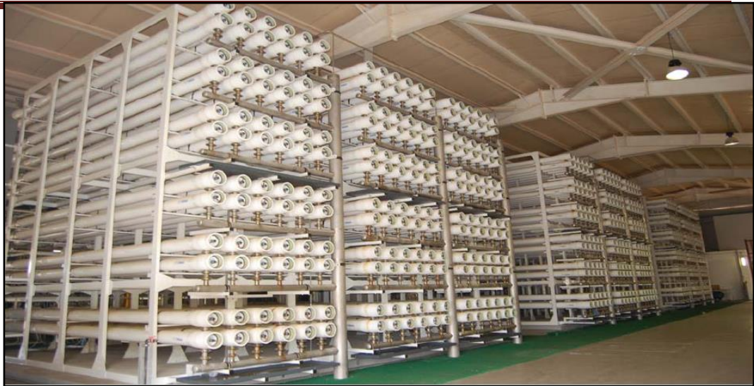
Figure V.12 : Unité d'osmose inverse
