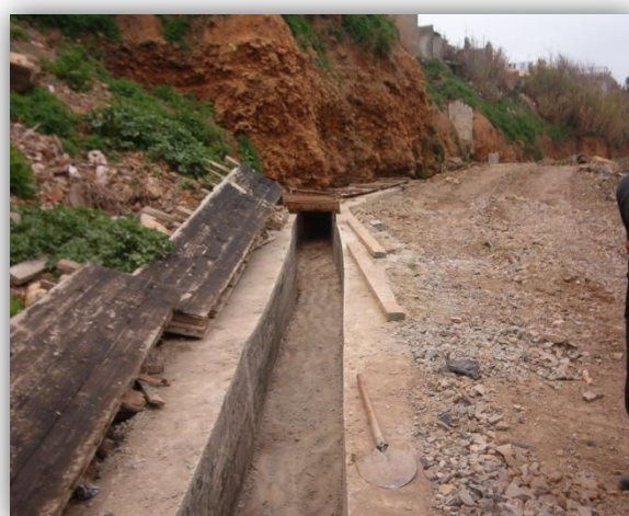
Photo n° 12 : Canalisation des eaux usées
