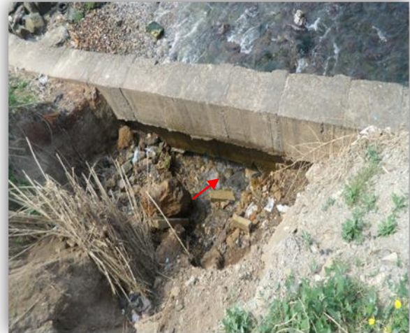
Photo n°4 : Avancement de la mer sur une partie de la falaise (pied de falaise dégradé).
