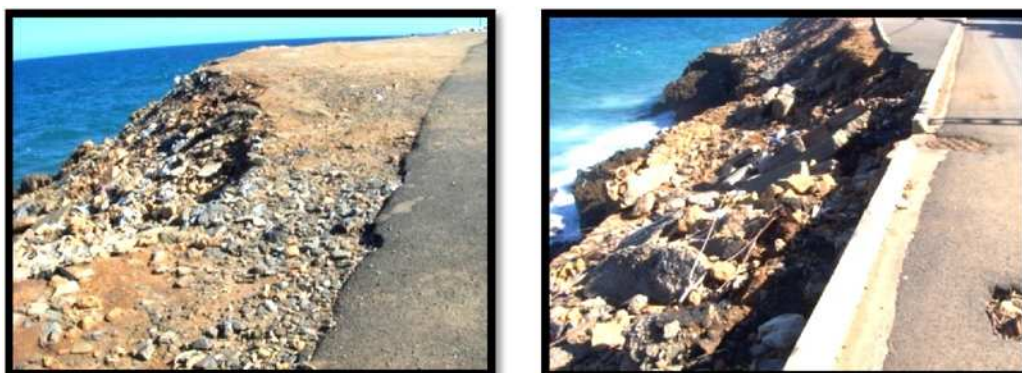
Figure 15 : Photos illustrant des ravinements créés par les ruissellements des eaux de pluies
