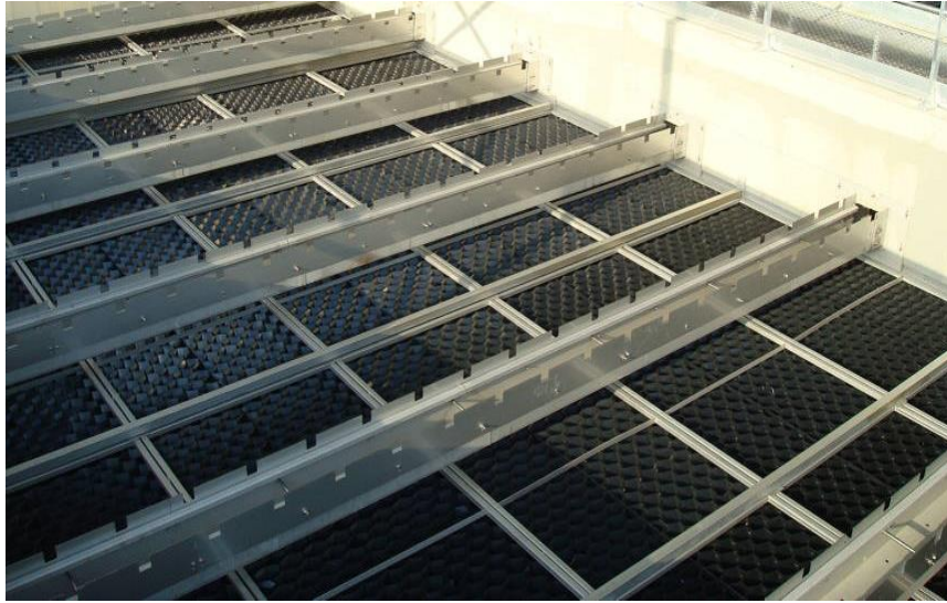
Figure II-3: Bassin de décantation.
