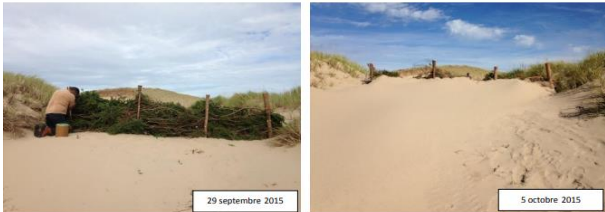
Figure 41: photo d'installation et d'évolution de fascine (De Sinety, M., Bourgeois, M., et, Giroux, M-E., Avril 2017)
