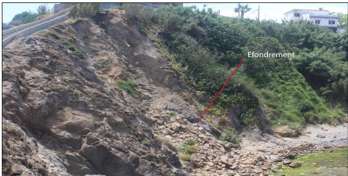
Figure 73: Effondrement des falaises de conglomérat escarpées au niveau d'une faille.
