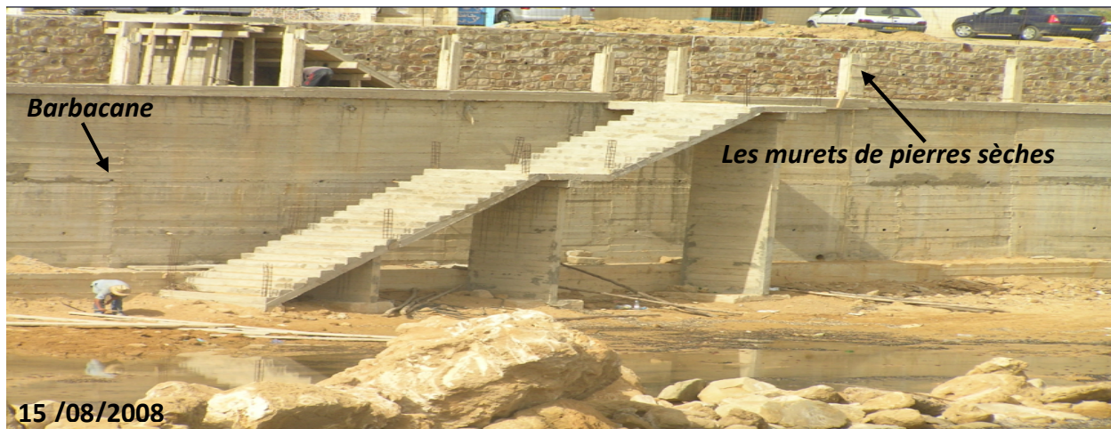
Figure N°II.4:photographie du mur en BA et de l'escalier et des murets de pierres sèches(HMI).
