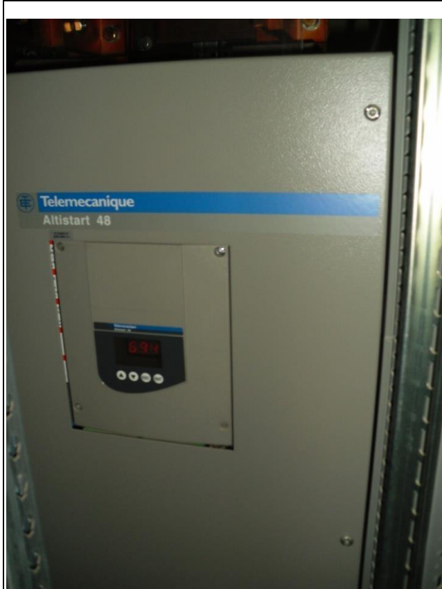
Démarrreur progressif ATS-48 Schneider Electric-Eau Traitée
