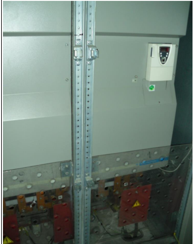
Variateur de fréquences ATV Schneider Electric MCC1 & 2
