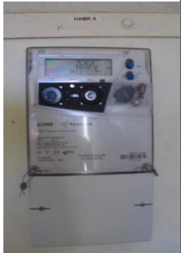
Compteur d'énergie arrivée Hamr Al Ain
