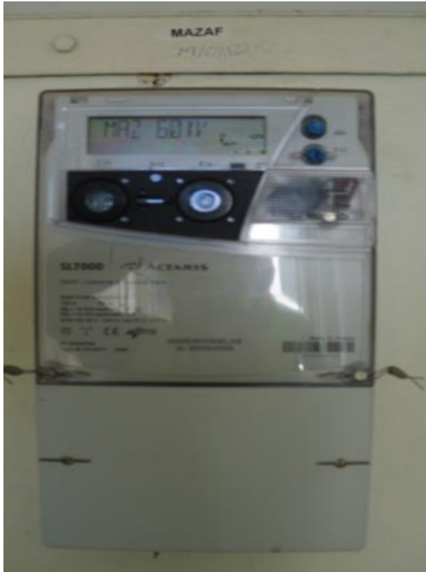
Compteur d'énergie arrivée Mazafran
