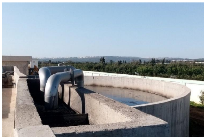
Figure VI-2 : le point de prélèvement "Epaississeur"
