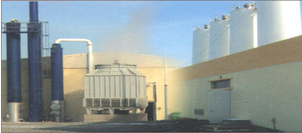
Figure 18 : système de reminéralisation et de production de CO 2
