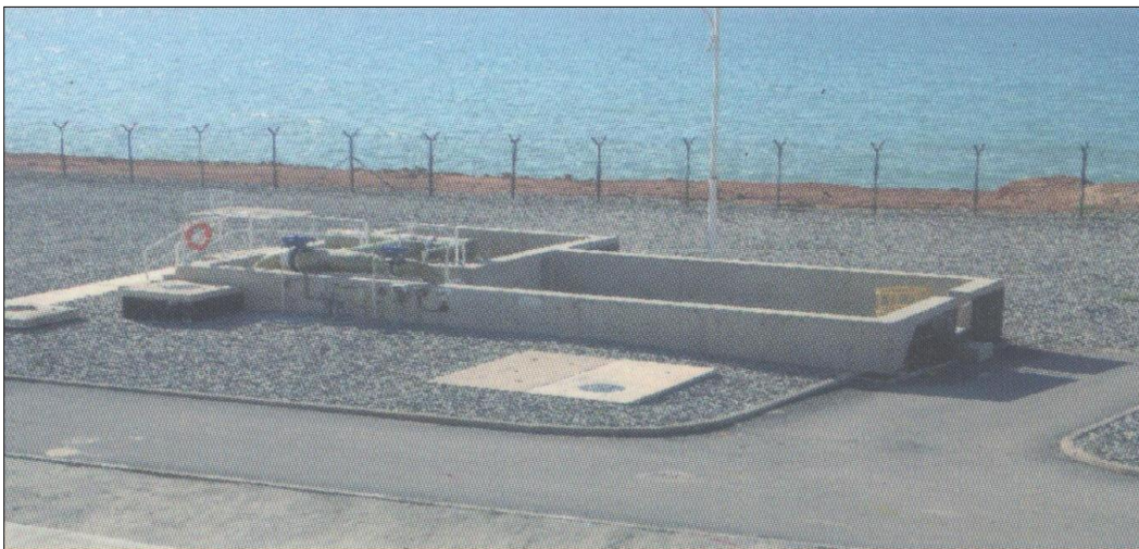
Figure 17 : réservoir de traitement des effluents (station de dessalement Fouka)
