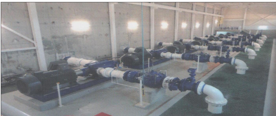
Figure 19 : Station de pompage d'eau traitée (station de dessalement-Fouka)
