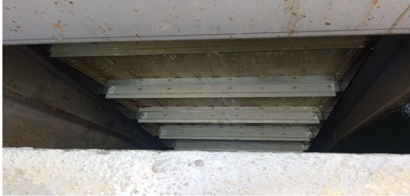
Figure 11: Système de filtre rotatif installé au niveau de la station d'EL Marsa (Hama et Kaab, mai 2023)
