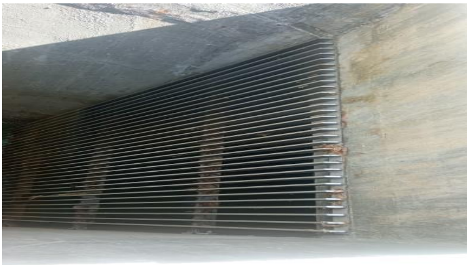
Figure 10 : Système de dégrillage installé au niveau de la station d'El Marsa (Hama et Kaab, mai 2023).
