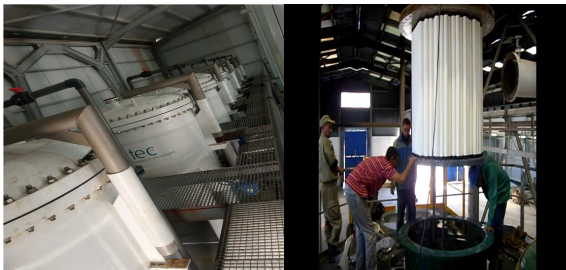
Figure 16 : Système de filtration à cartouches installé au niveau de la station d'El Marsa (Hama et Kaab, mai 2023).
