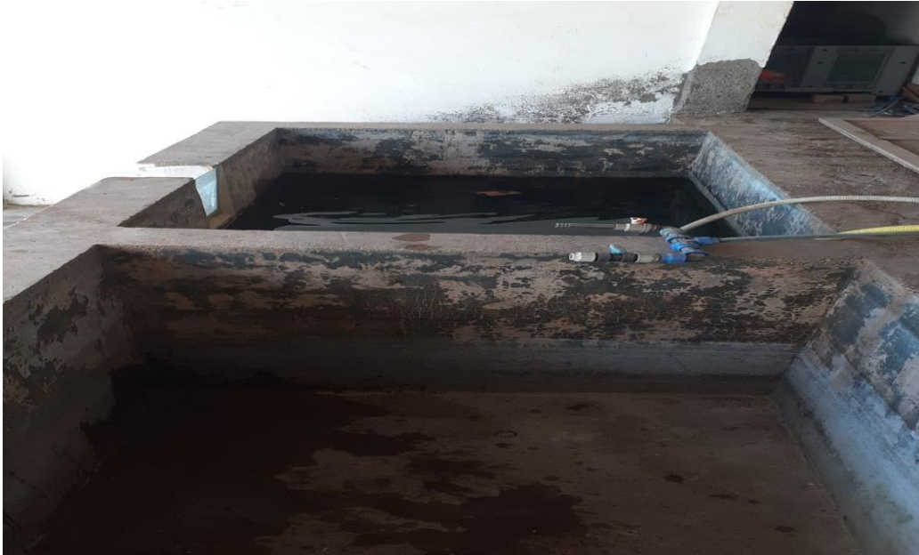
Figure 65: Bassins de stockage d'Orca Marine.
