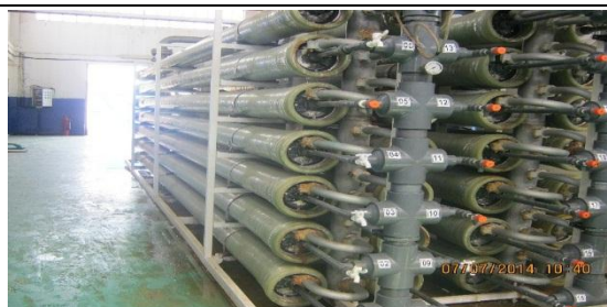
Figure II.16. Photographie système de membranes d'osmose inverse
