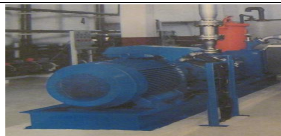
Figure II.15. Photographie d'une pompe à haute pression
