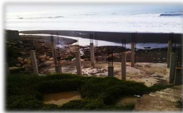
Photo VI. 3: construction illicite au bord de la mer dans la côte Est
