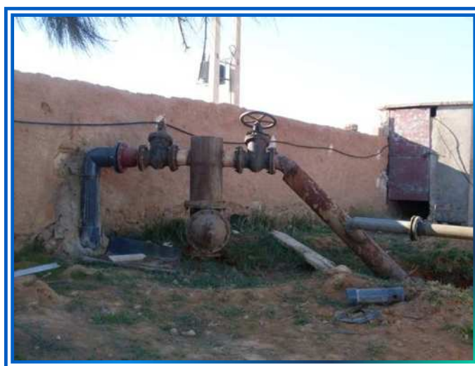
Figure II.4 : Tête du forage
