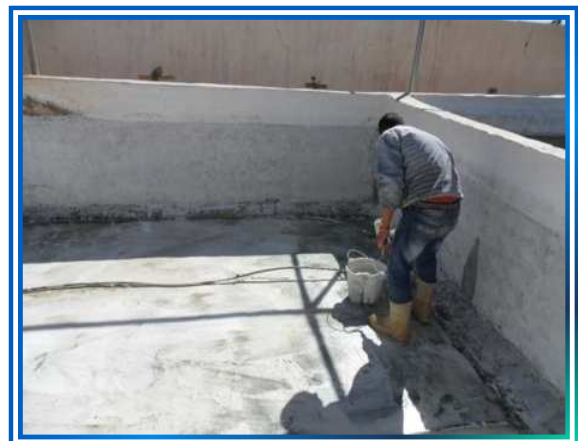
Figure III.3 : Chaulage des bassins
