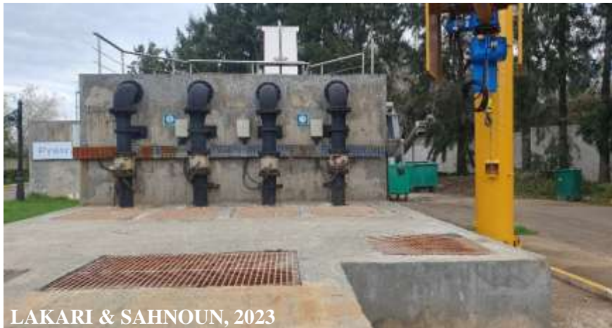
Figure 05 : Le poste de relevage
