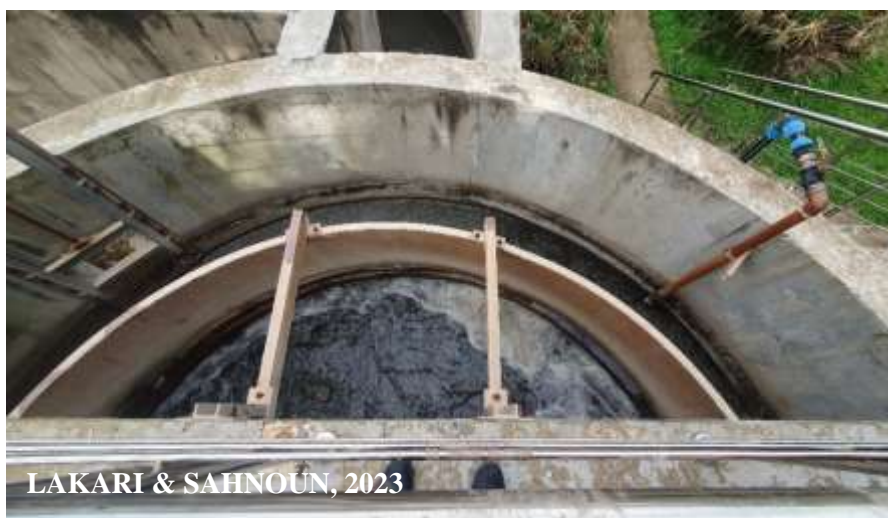
Figure 06 : Le déssableur/ déshuileur
