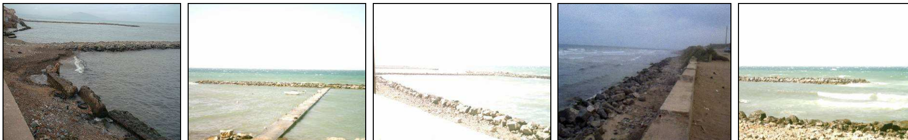
- Ouvrages de protection inefficaces -
