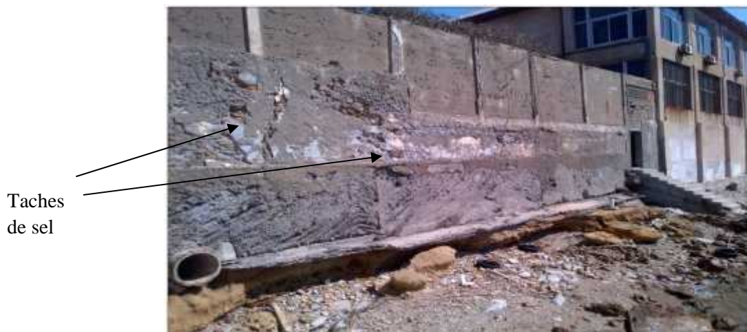
Figure n°36: Taches de sels sur les murs extérieurs de la station ENSSMAL (2015)
