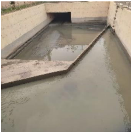
Figure 11 : entrée de l'eau brute
