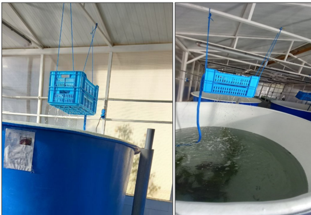
FIGURE II.4 – Photos de système de filtration installé.
