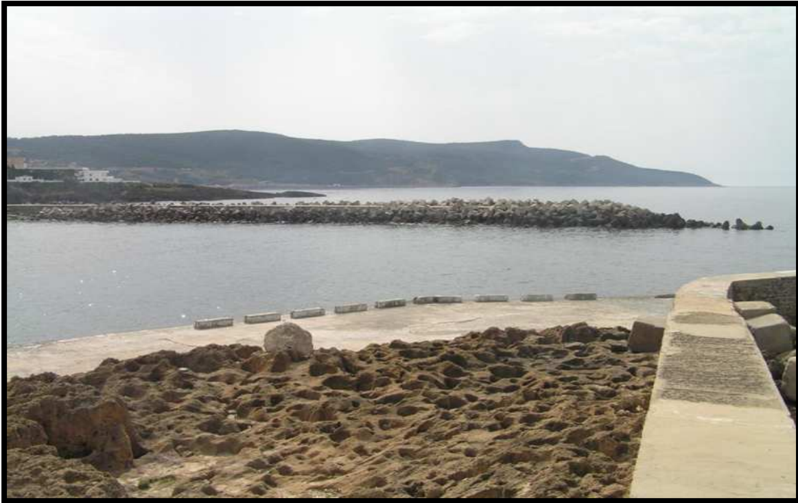
Photo 1 : Vue de la passe d'entrée et de la jetée endommagée
