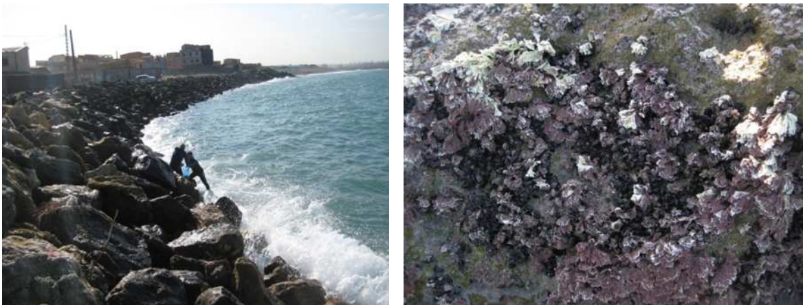
Figure7 : Moulière du bateau cassé sur rochers artificiels
