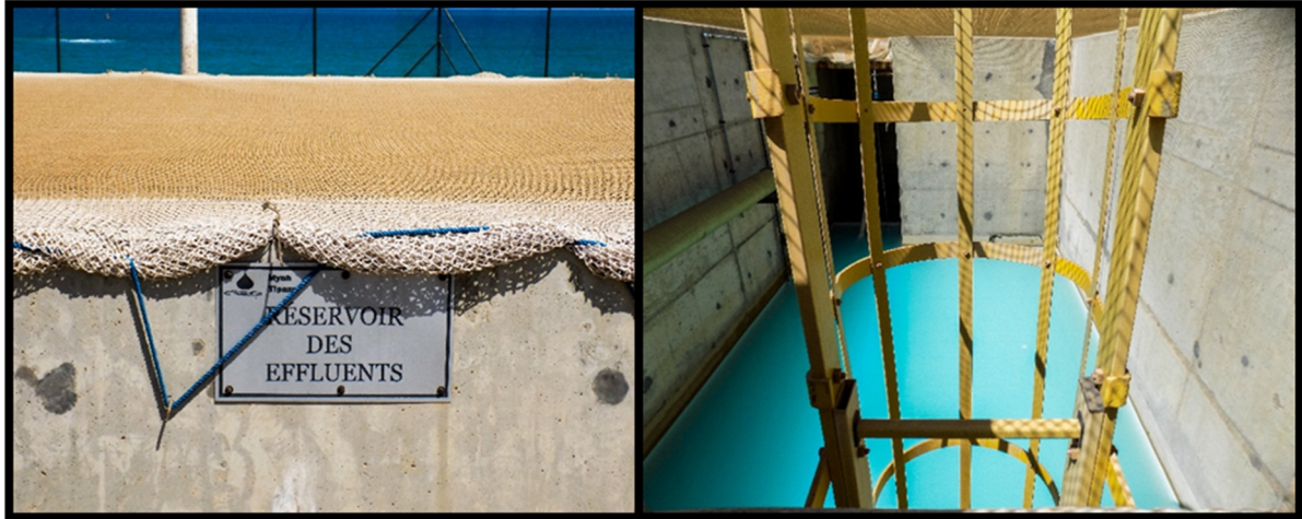
Figure 24 : Réservoir des effluents
