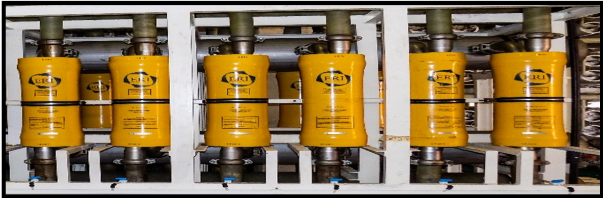
Figure 22 : Dispositif de récupération d'énergie ERI
