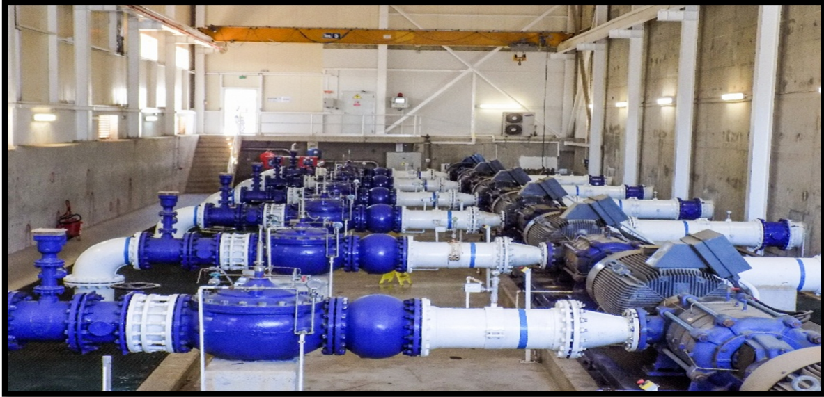
Figure 26 : Station de pompage d'eau traitée
