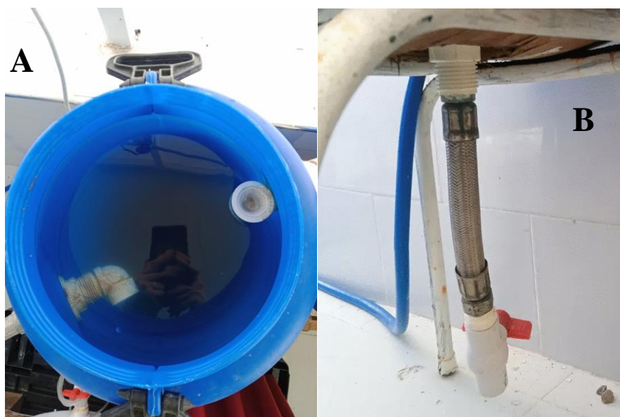
Figure 20 : Filtre tourbillon (A, Les coudes PVC du filtre. B, Robinet de vidange au fond du filtre)
