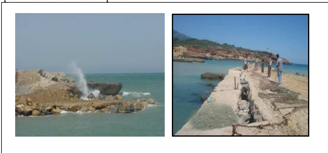
Fig II-8: Détérioration des jetées Est et Ouest du port de Tipaza.
