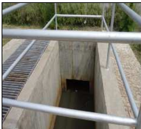
Figure IV.3 : poste de relevage
