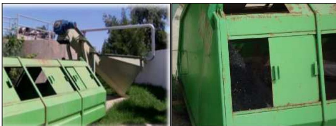
Figure IV.6: Banne pour la récupération du sable
