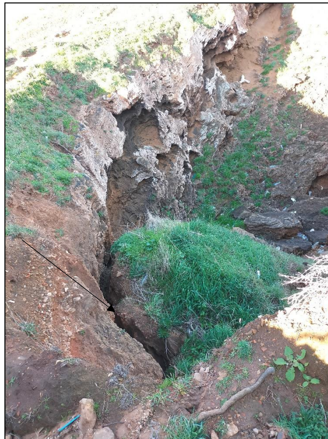
Figure 61 Les problèmes géotechniques engendrés (2024)
