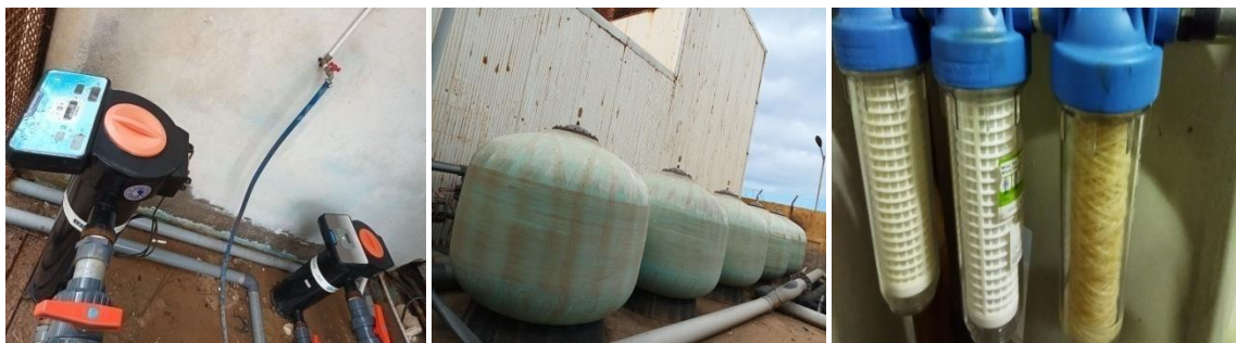
Figure II.4 : Systèmes de filtration de l'eau de mer (UV, filtres à sable, filtres à cartouches).
