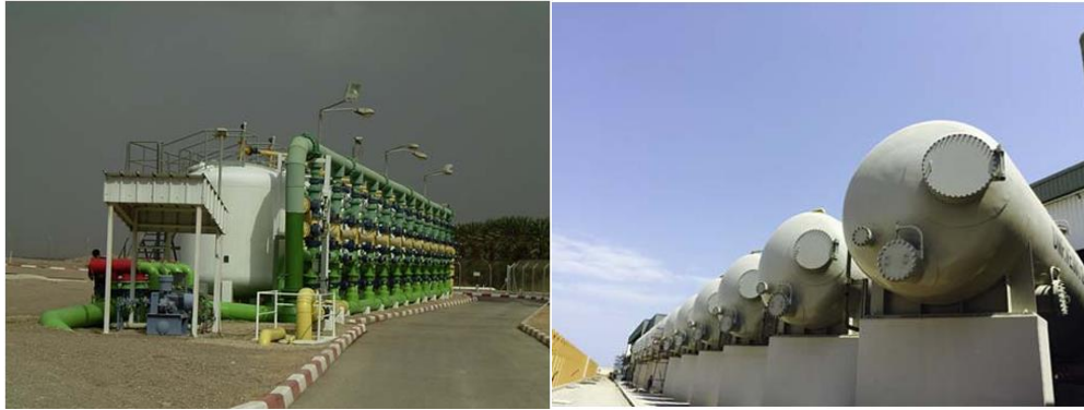
Figure 1.5: les filtres pressurisés (Kadouche et al., 2018)
