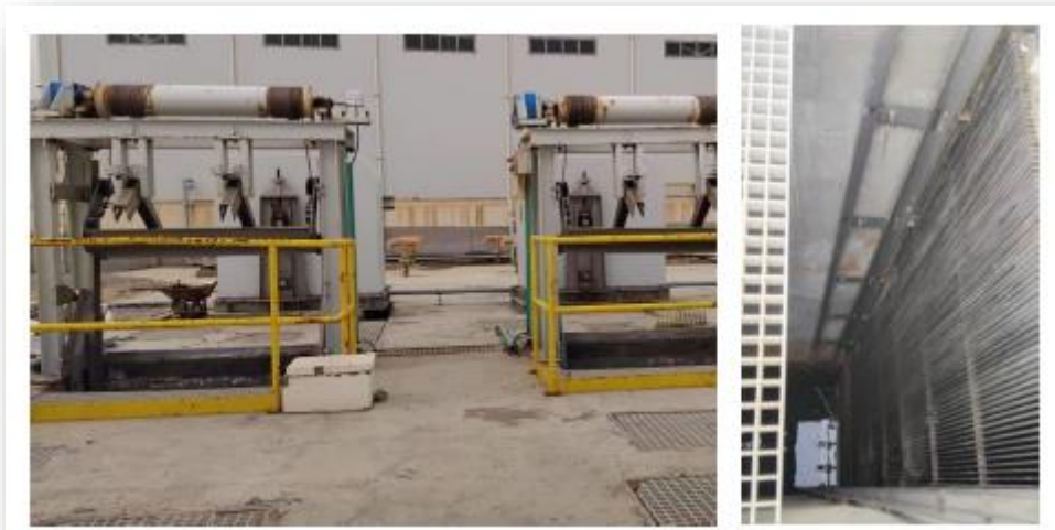
Figure 2.7: les dégrilleurs à barre (Madoui, 2023)
