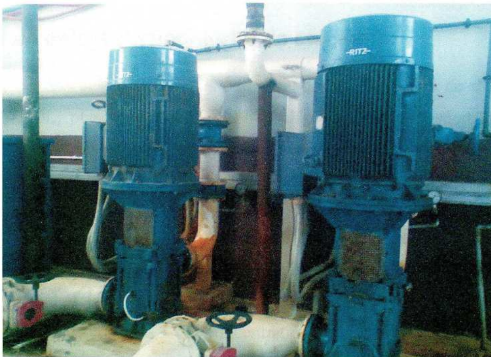
Figure 17 : les pompes de refoulement
