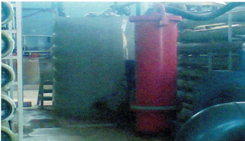
Figure 16 : l'installation de nettoyage des membranes d'osmose inverse.
