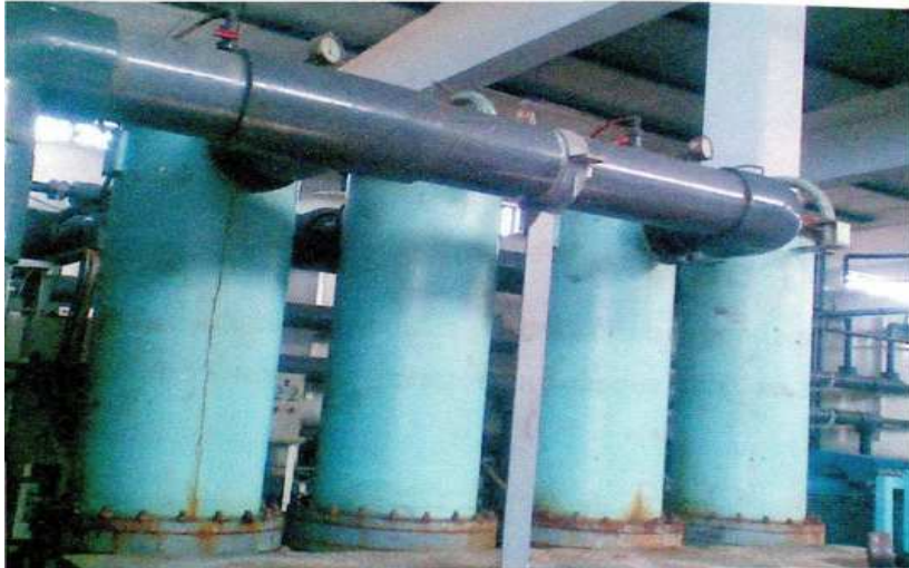
Figure 12 : l'installation de la micro filtration.
