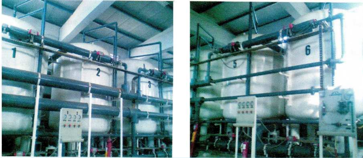
Figure 10 : les six (06) filtres à sable.
