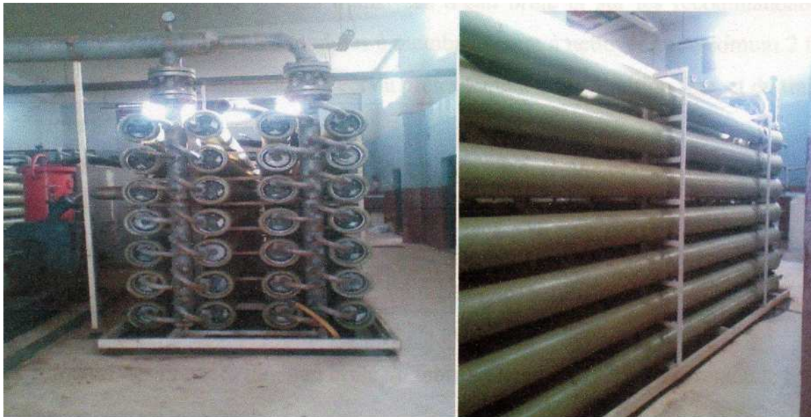
Figure 14 : l'installation d'osmose inverse.
