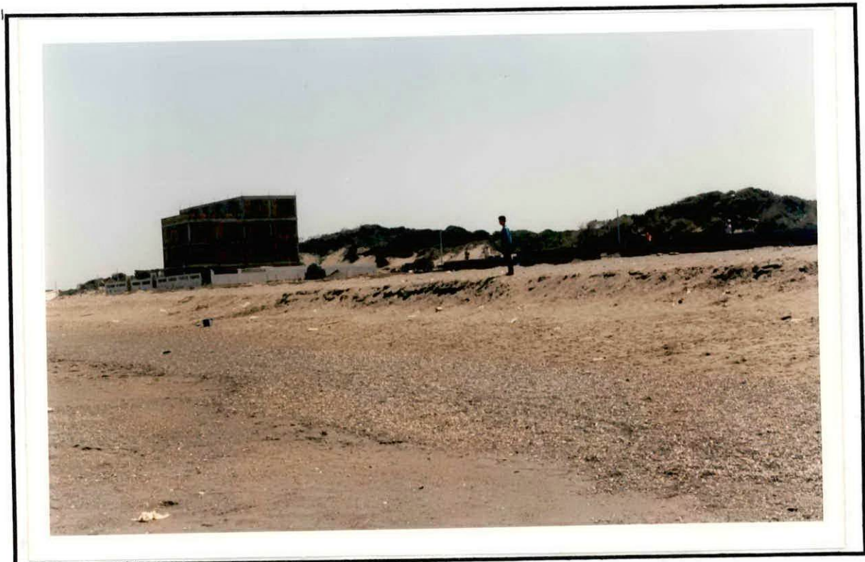
Photo n° 6 : Rupture de pente au niveau de la haute plage.
