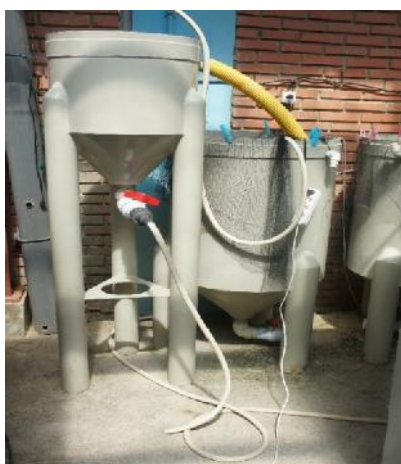
Figure 28. Système de décantation du floc
