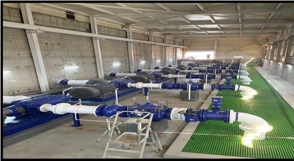
Figure III.20: Station de pompage d'eau traitée. (Source : L. Dehia, H. Hayet ;2023)
