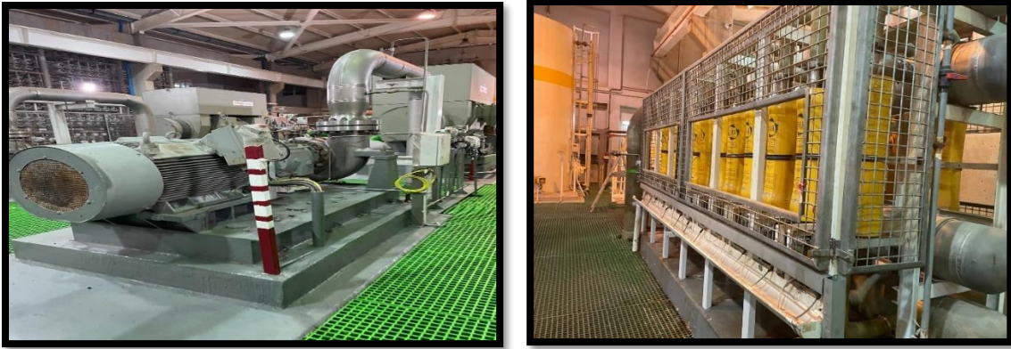
Figure III.18: La pompe HP et l'échangeur de pression ERI utilisé à l'usine.
