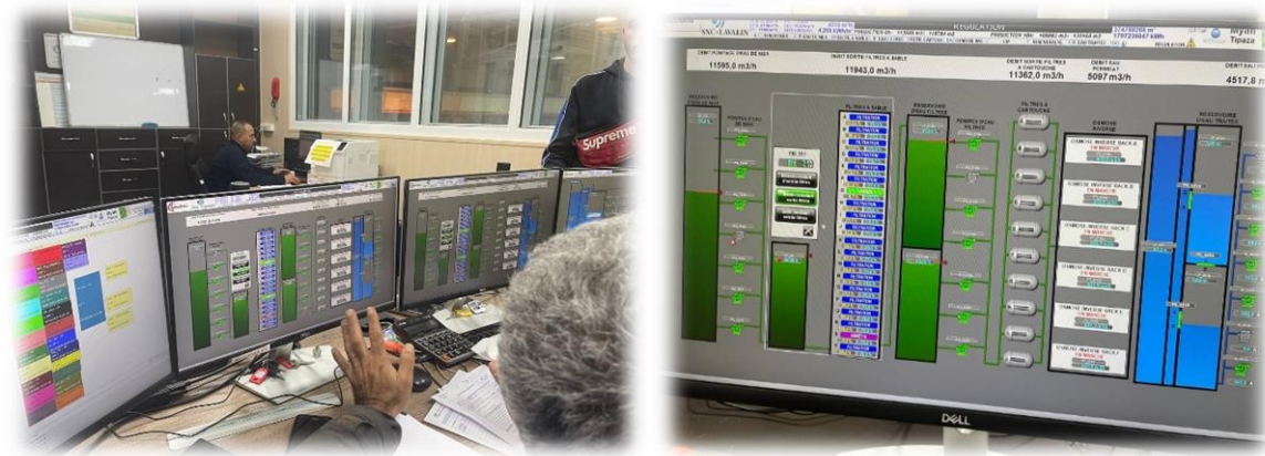
Figure III.12: Salle de contrôle de la station de dessalement Fouka marine.
