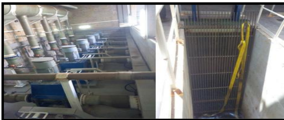
Figure III.14 : Dégriilleurs et station de pompage d'eau de mer. (Source : Taibi Sarah, 2015)
