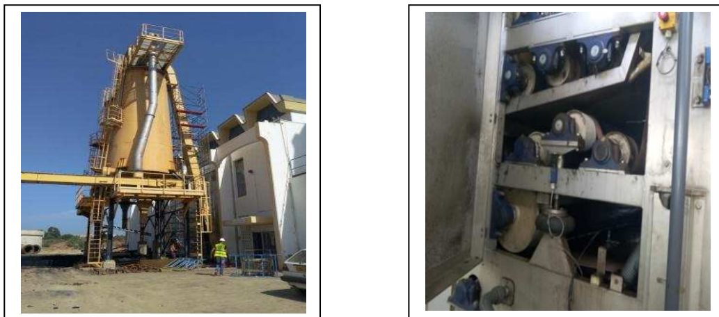
Figure III.12 : Silo à bande, filtre de polymère boue/polymère
