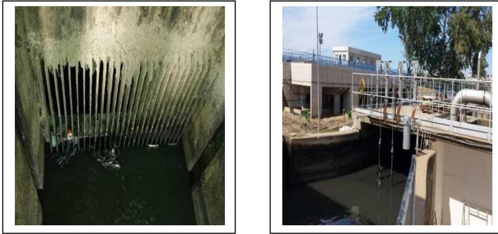
Figure III.4 : Dégriilleurs, les sondes
