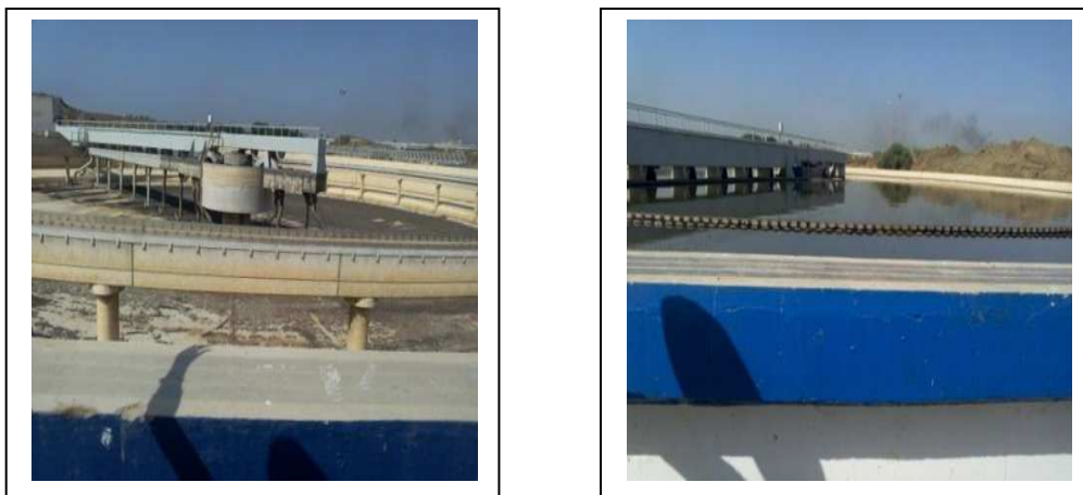
Figure III.8 : Clarificateur vide, clarificateur plein
