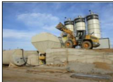
Photo VIII-2 : Centrale et stockage du béton.
