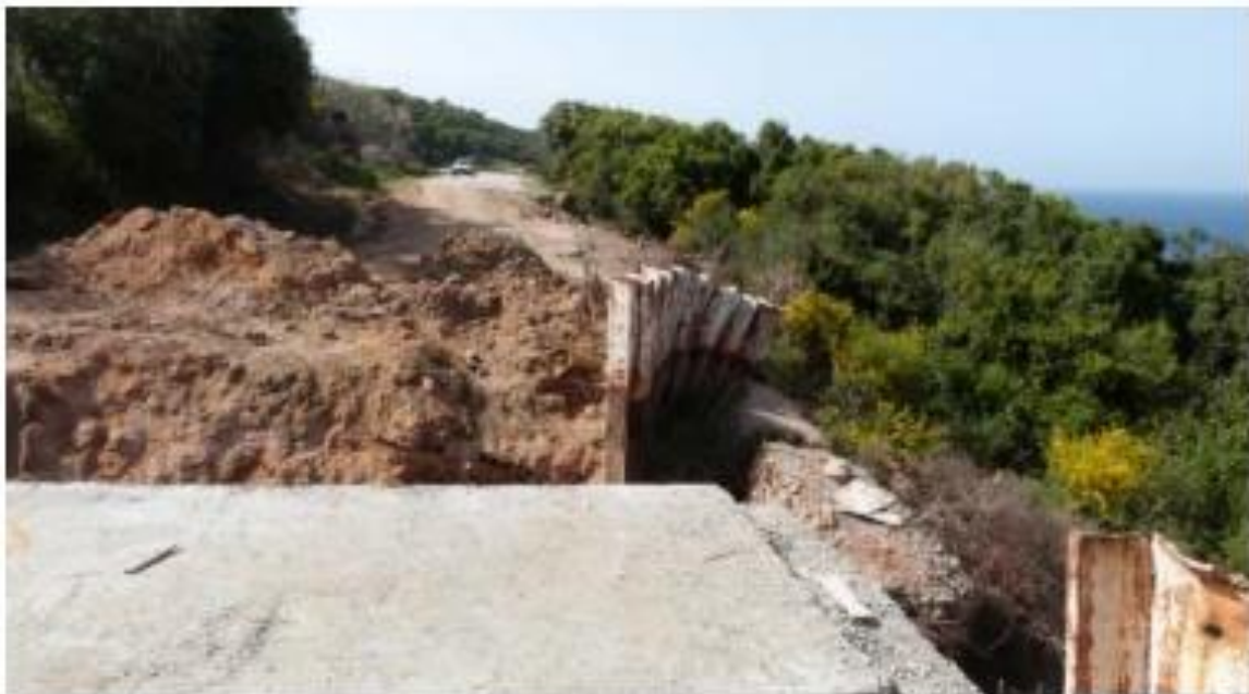
Figure 2. 19: Glissement de terrain (commune d'El kala)
