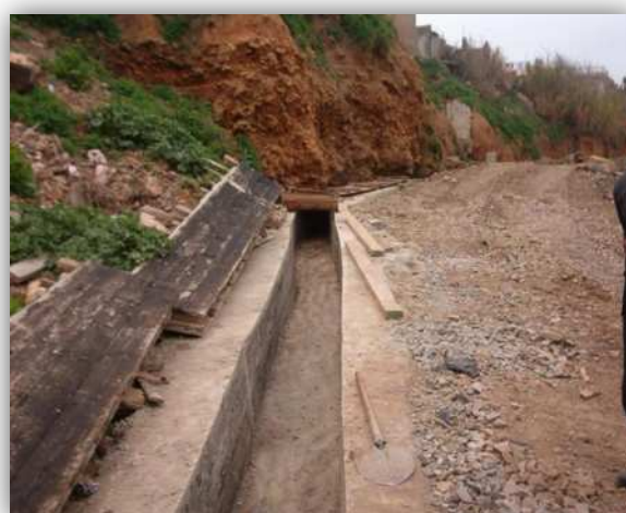
Photo n° 12 : Canalisation des eaux usées
