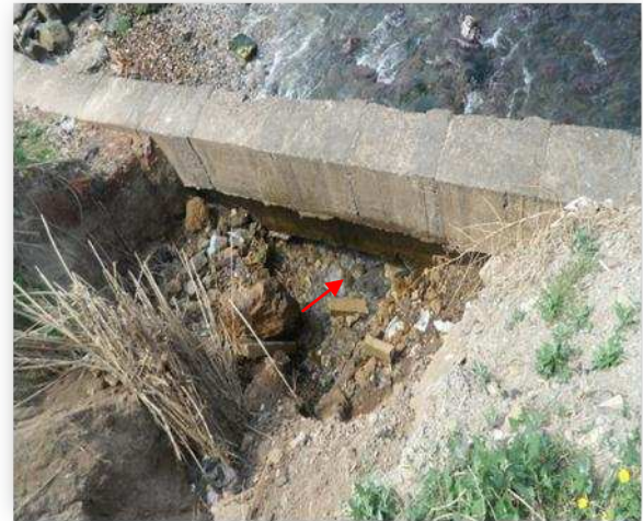
Photo n°4 : Avancement de la mer sur une partie de la falaise (pied de falaise dégradé).
