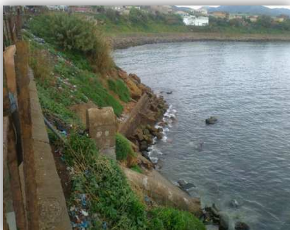
Photo n° 9: Ouvrage de protection -site Ouest-
