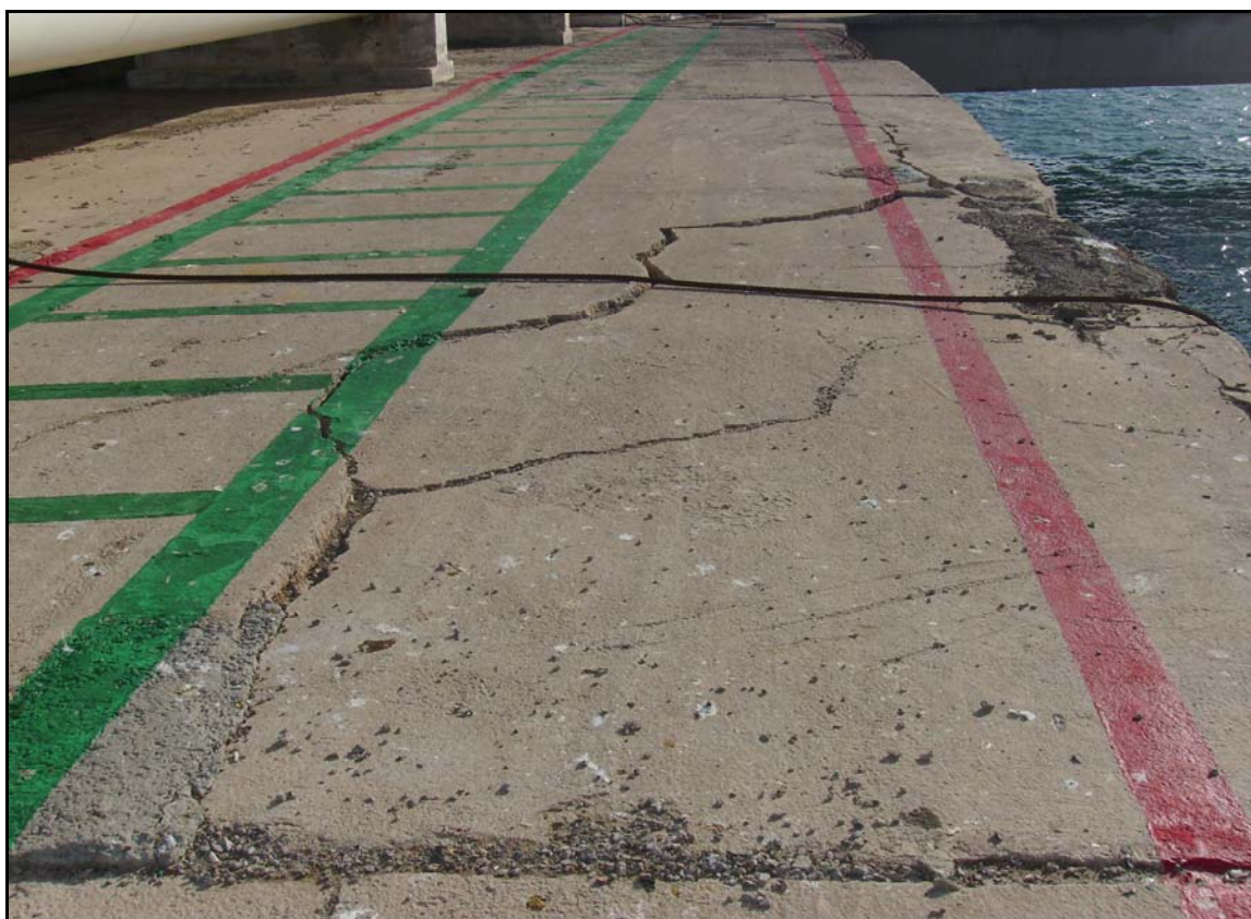
Photo N°3 : fissuration et tassement très visible de la dalle de couronnement
