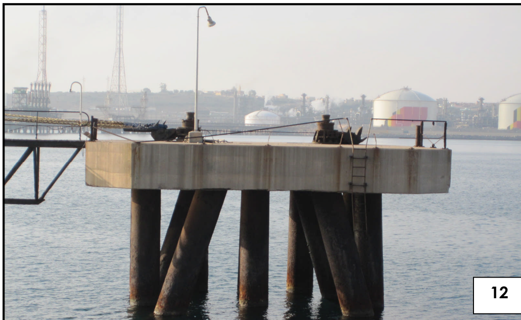
Photo N°12: le béton de couronnement de la pile d'amarrage la plus à l'Ouest du poste B3 est dans un bon état , les garde corps par contre sont dans un état de vétusté très avancée.
