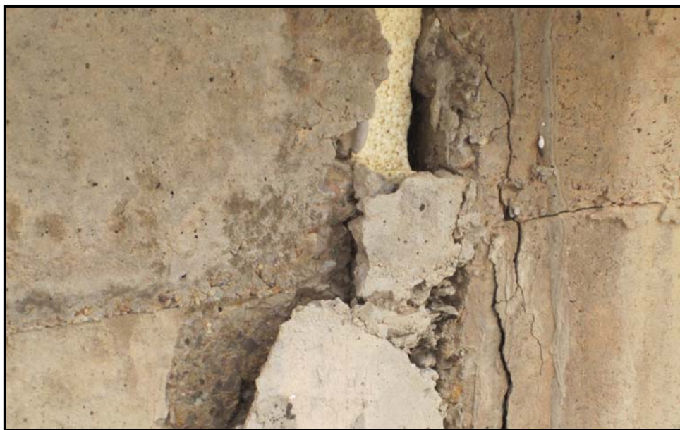
Photo N°4 : éclatement du béton dû à la friction thermique du mur de garde lors de la tempête du 14 au 15 Décembre 2009.
