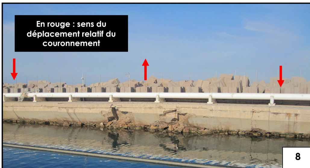
Photo N°8: Eclatement de béton du à la friction et <<tamponnement>>entre les plots résultant des efforts engendrés par la houle suivi du tassement du couronnement (mi - distance entre le poste B1 et le Poste B2). Le mur de garde en BCR de 60t reconstruit après la tempête est en bon état
