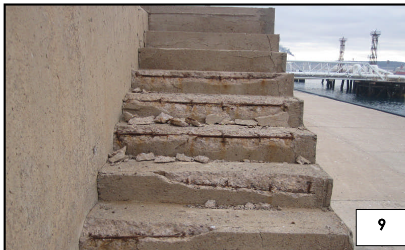
Photo N°9: dégradation de l'escalier situé entre le poste B3 et le musoir Ouest due aux franchissements de la houle
