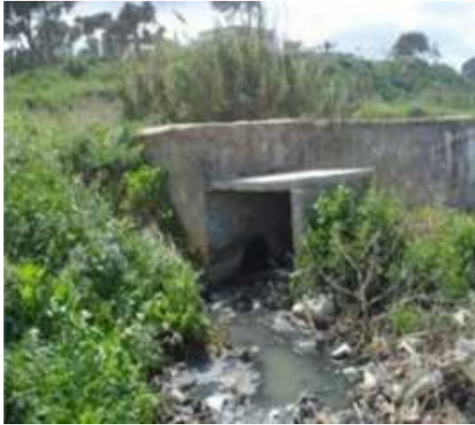
Photo No.03 : Rejet d'eaux usées
